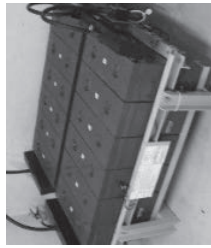
蓄電池の増設
