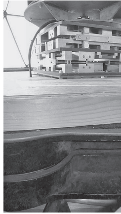
図12 江崎灯台の免振装置（上） と耐震装置（下）
